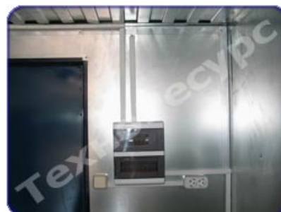
Автоматические выключатели, проводка в кабельном канале
